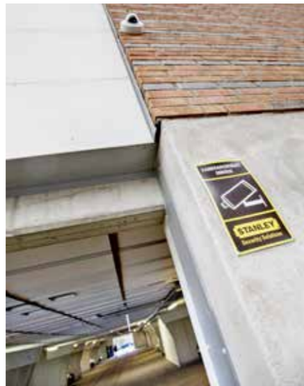
▲ Kameraet fanger opp trafikk ut og inn fra garasjeanlegget.
